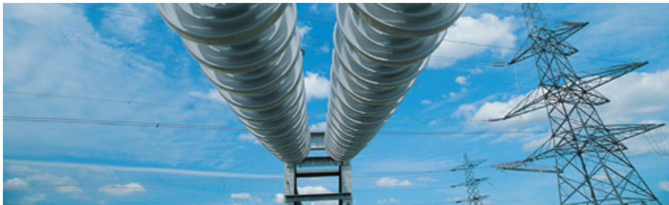
Isolatorkette für den Einsatz in Hochspannungsmasten
